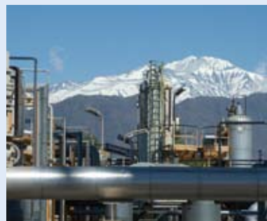
Petroquímica Cuyo. Planta de polipropileno. Lujan de Cuyo, Mendoza
